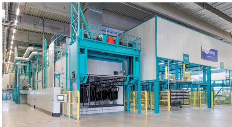
Das Produktionsvolumen der neuen KTL-Anlage umfasst zirka 1.000 m 2 zu beschichtende Oberfläche pro Stunde. Mit ihr werden im 3-Schicht-Betrieb Karosserieanbauteile und Kfz-Strukturbauteile mit einer Größe von bis zu 3,30 m x 1,25 m x 1,90 m beschichtet.
